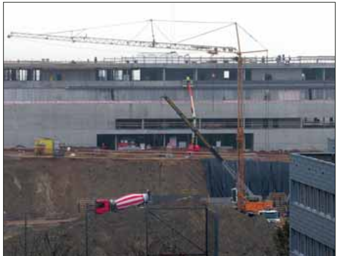
Ansicht auf den außerschulischen Eingang an der Nordfassade; hier finden gerade Betonierarbeiten bei der Freisport-Tribüne statt.
